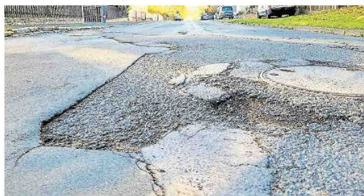
Die Fasanenstraße in Westerode hat eine Sanierung sichtlich nötig. Die möchte die Stadt nun in Angriff nehmen. Archivfoto: Exner
